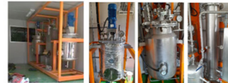
Gambar 5. Pilot Plant Produksi Furfural dari TKKS berbasis Hidrolisis: (a) Infrastruktur overall, (b) Tangki pretreatment, (c) Reaktor dan (d) Kondensor
